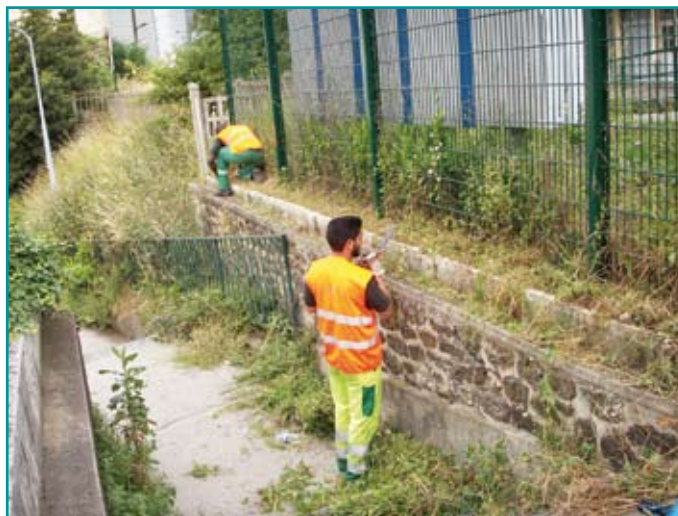
Des salariés du chantier d'insertion pratiquent la taille à proximité de la gare à Courbevoie.
